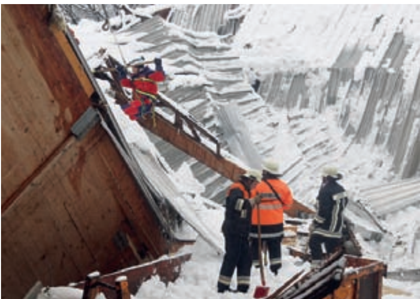
Abb. 5: Einsturz der Eissporthalle in Bad Reichenhall am 2. Januar 2006: Auch hier halfen Einsatzkräfte der Bergwacht
